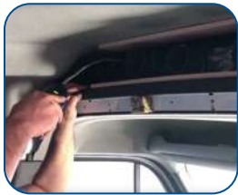
Fuga en evaporador de ambulancia.
